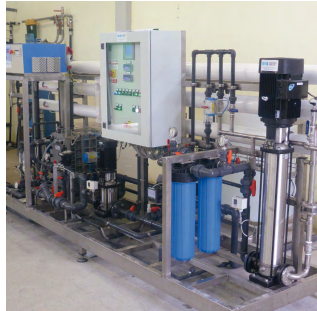
Impianto osmosi inversa per trattamento acque lavaggio bottiglie.
